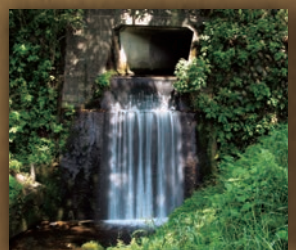
△現在の工場排水口。
