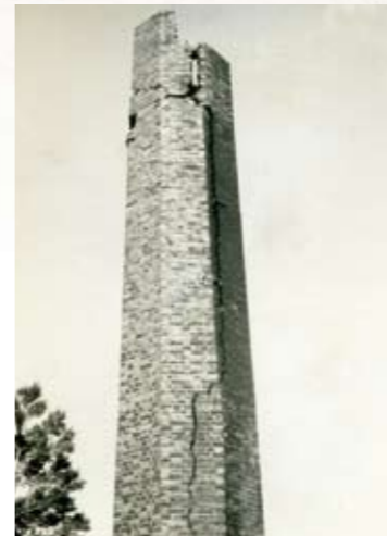
新潟地震直後のひび割れた煙突 (写真提供:小田製陶所)
